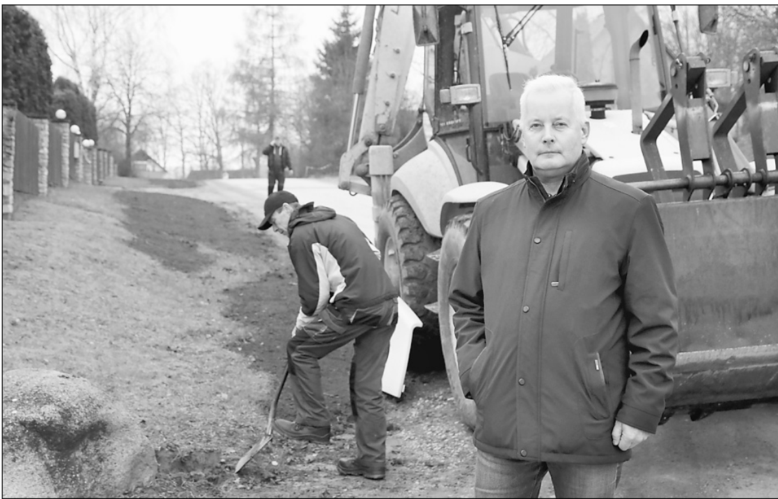
— Projekta ietvaros septiņās ielās pilsētā uzlabota pilsētas centralizētās siltuma pārvades sistēmas darbības efektivitāte, nodrošinot nepārtrauktu un stabilu siltumenerģijas piegādi esošajiem un potenciāli jaunajiem patērētājiem, — informē Ivars Grandāns.
